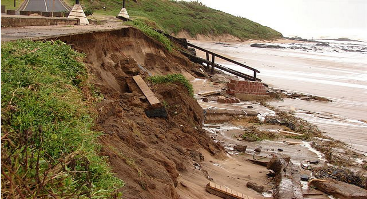
Рис. 6.4. Абразионная деятельность на сооружение
